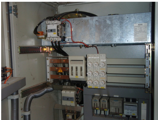
Einspeisung mit 400 V Drehstrom
