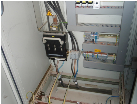
Absicherung über Niederspannungs Hochlastsicherungen
