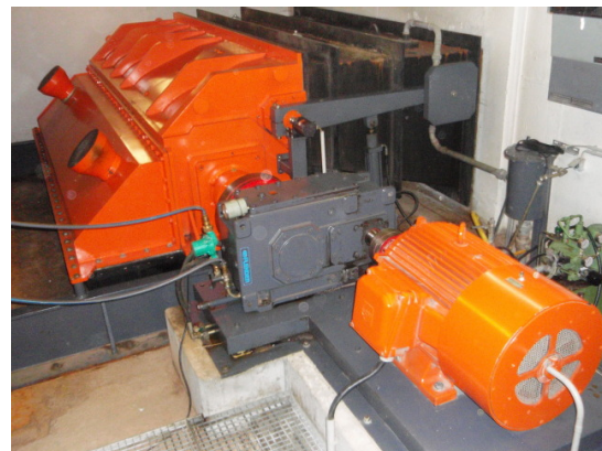
Turbine hinten / Asynchronmaschine als Generator vorne
