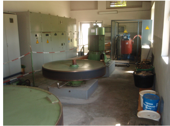
Blick in das Maschinenhaus
