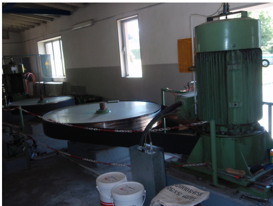
Älterer Generator mit Schwungscheibe über Riemen gekoppelt.
