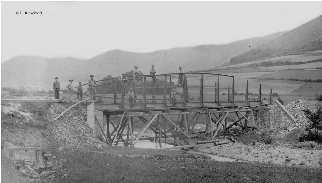
Das Foto im Besitz von Eduard Rickelhoff: Der Bau der Lennebrücke in Gleierbrück zu Beginn des 20. Jahrhunderts
